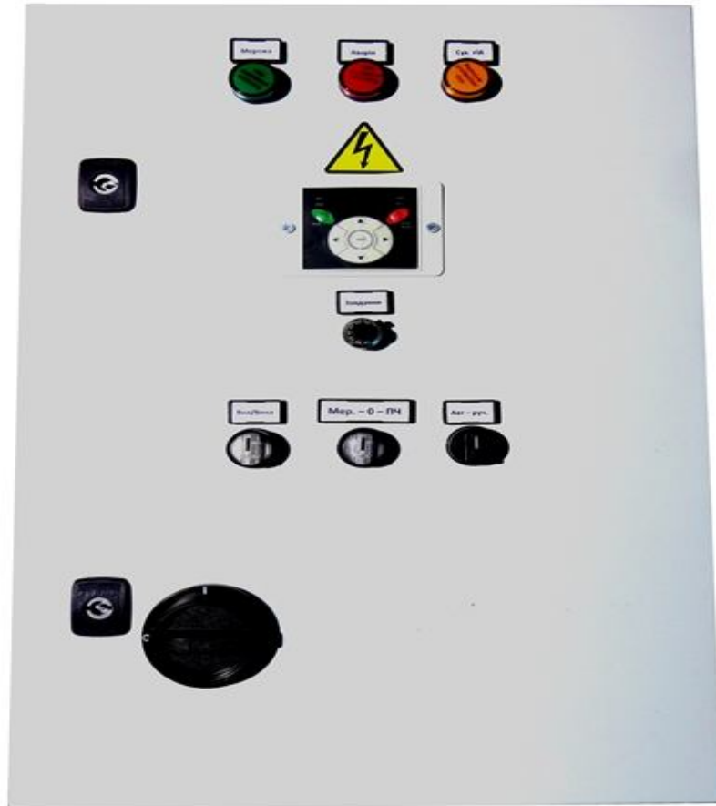
Рисунок 2.14 – Насосна станція панель керування
