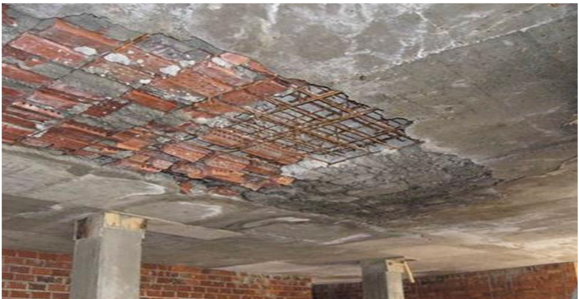
Рис. 3.6 - Дефекти ділянок кладки
