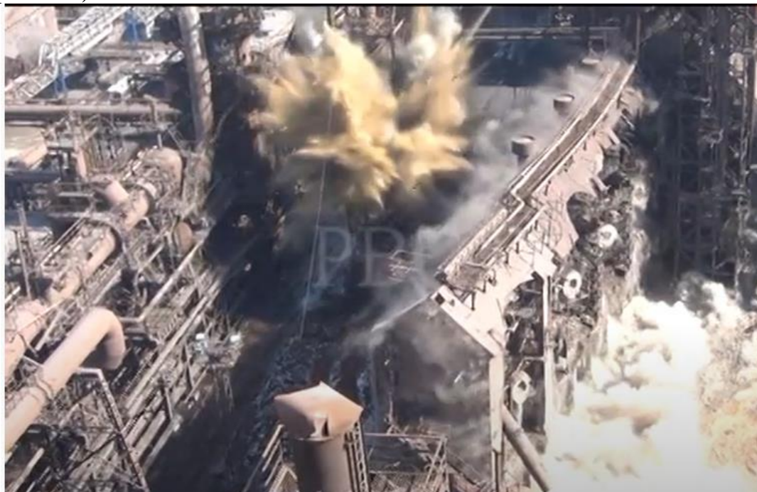
Рисунок 5.6 – Вибух приміщення повітрянагрівачів і труби на тягу, доменна піч №3 НТМК Н. Тагіл 2012.04.08
