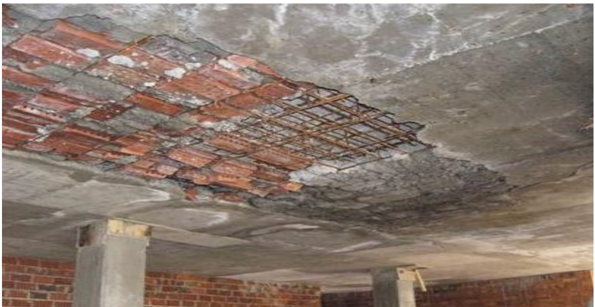
Рис. 3.6 - Дефекти ділянок кладки
