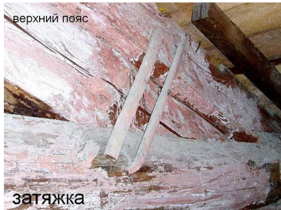
Рис. 3.4 - Дефекти дерев'яних конструкцій
