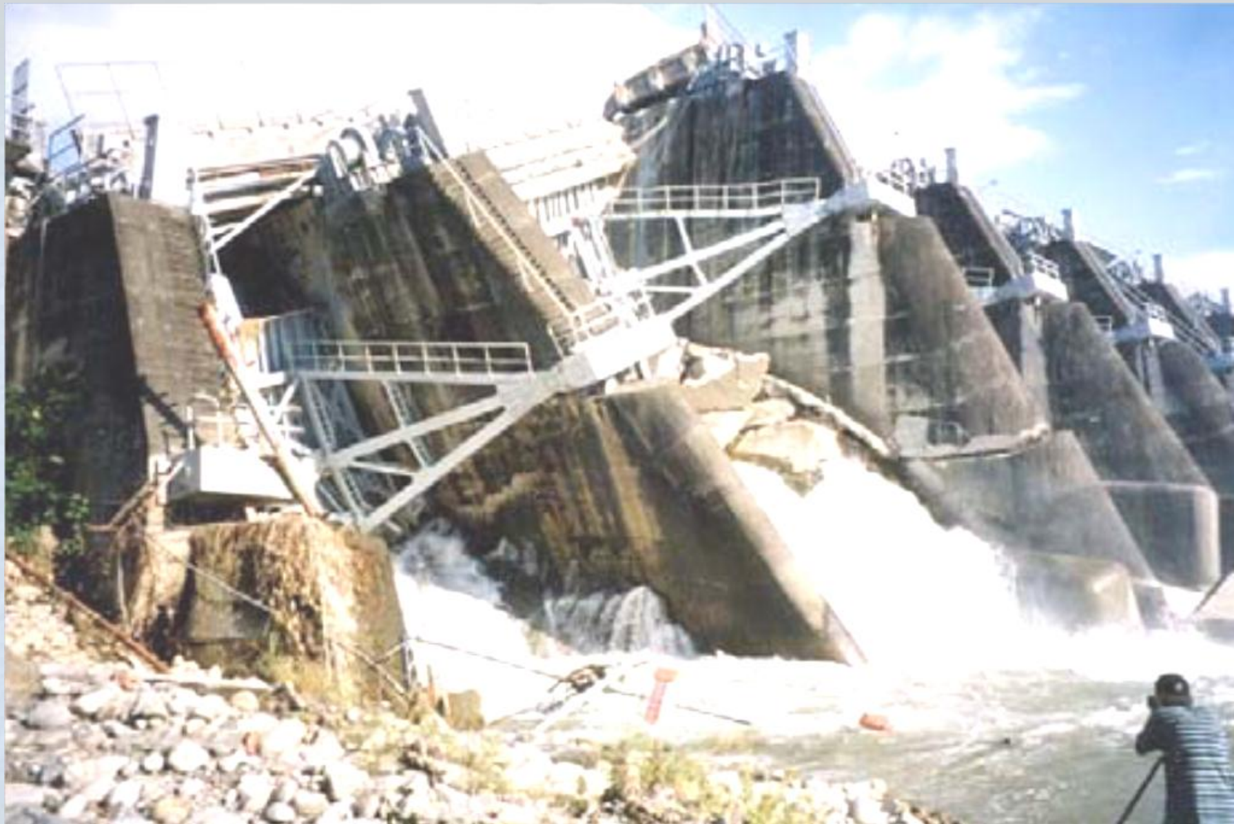
Аварія на греблі Шіх Канг при землетрусі (Тайвань, висота 25 м, 23 вересня 1999 р.)
