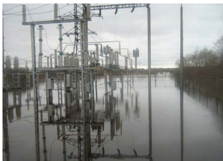
Рис. 4.7. Затоплена електрична підстанція
