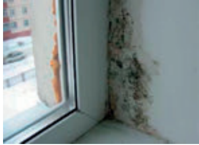
Рис. 2.4.20. Утворення плісняви на віконному відкосі
