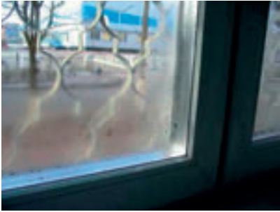
Рис. 2.4.19. Утворення конденсату на поверхні вікна
