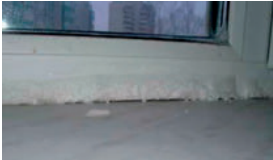
Рис. 2.4.21. Утворення льоду на підвіконні
