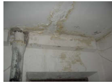
Протікання води через дах
