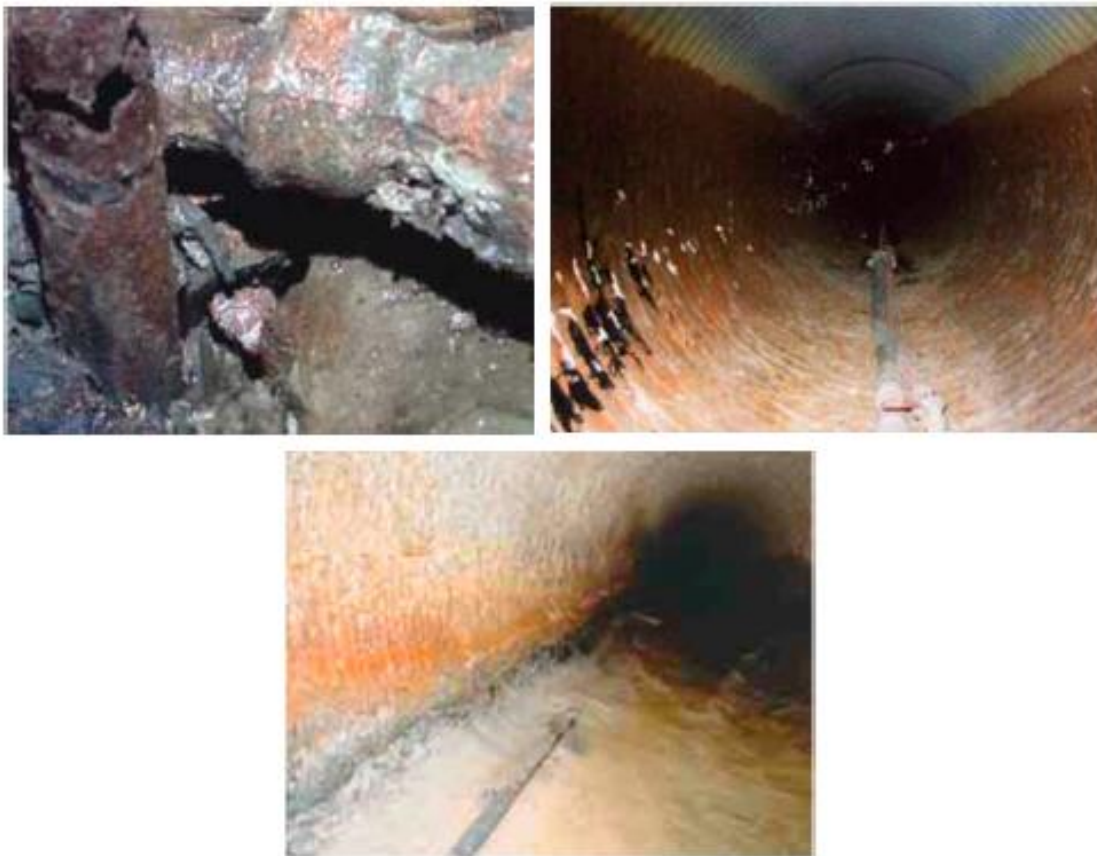
Рис. 2.1. Трубопроводи водовідведення, зруйновані корозією
