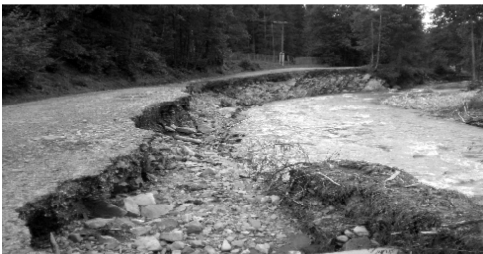
Рис. 11.2. Зруйноване полотно дороги під час паводку (Прикарпаття, 2008 р.)
