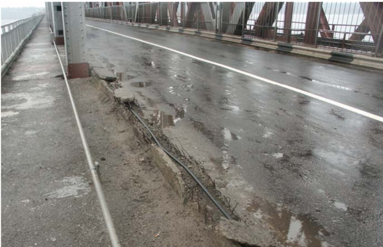
Хлоридна корозія бетонного бордюру
