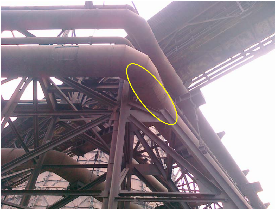
Фото 11 – Механическое повреждение – вырез участка подкоса опоры К-2 по оси 2. Профиль трассы 2-7. Категория повреждения по [2] – А, группа 1.1, таблица 10
