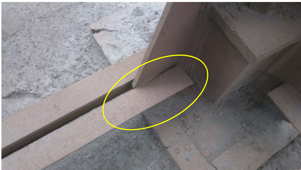
Фото 15 – Разрушение сварного шва крепления распорки решетки к опоре К-5 ось 5. Профиль трассы 2-7. Категория повреждения по [2] – А, группа 4.11, таблица 10
