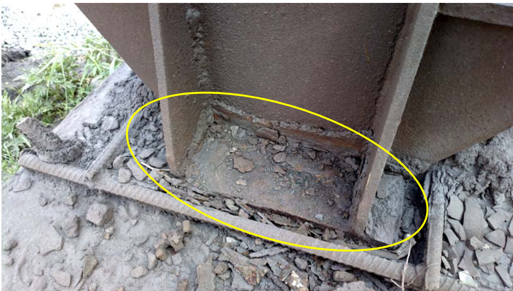
Фото 24 – Разрушение антикоррозионного покрытия опорной плиты опоры К22 по оси 455а. Коррозия до 30% от площади поперечного сечения элемента. Категория повреждения по [2] – В, группа 12.2, таблица 10
