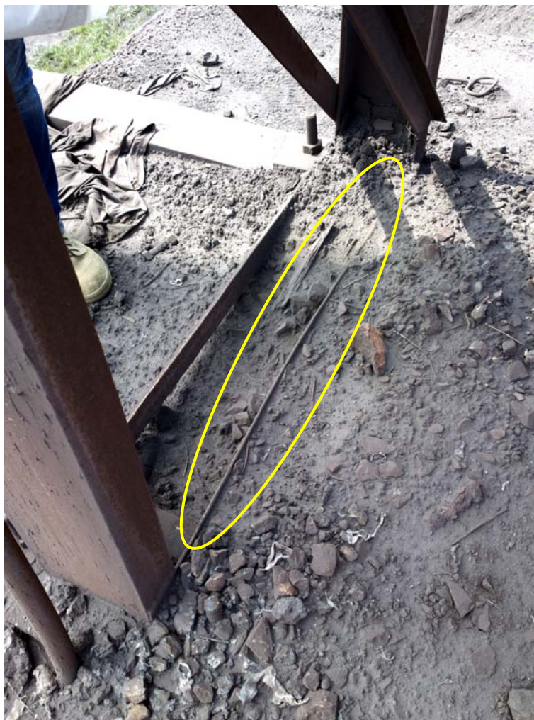
Фото 25 – Погнутость распорки опоры К24 по оси 402а в сторону оси 402 на величину f=50 мм. Профиль трассы И-402а, 402. Категория повреждения по [2] – Б, группа 6.1, таблица 10
