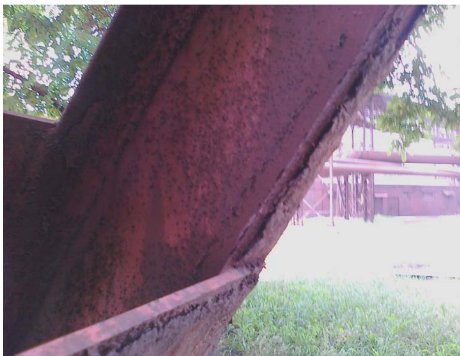
Фото 8 – Характерное повреждение – разрушение антикоррозионного покрытия конструкции опоры эстакады. Коррозия до 3% от площади поперечного сечения элемента. Категория повреждения по [2] – В, группа 12.2, таблица 10
