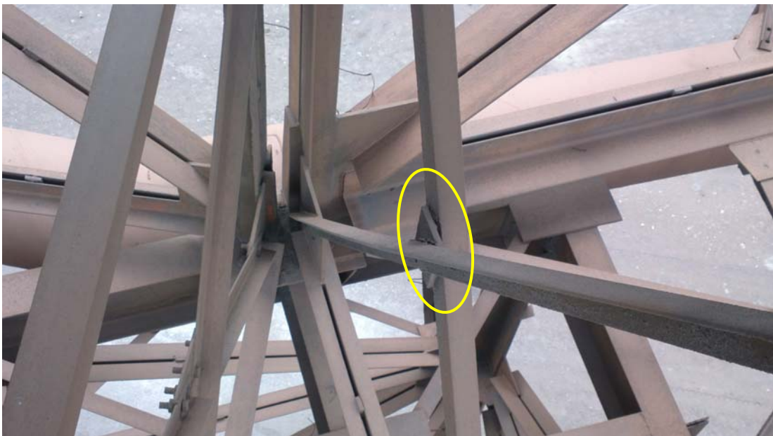
Фото 6 – Разрушение сварного шва узлового соединения элементов вертикальной связи пролетного строения к фасонке, по оси 5. Профиль трассы 2-7. Категория повреждения по [2] – А, группа 3.1, таблица 10
