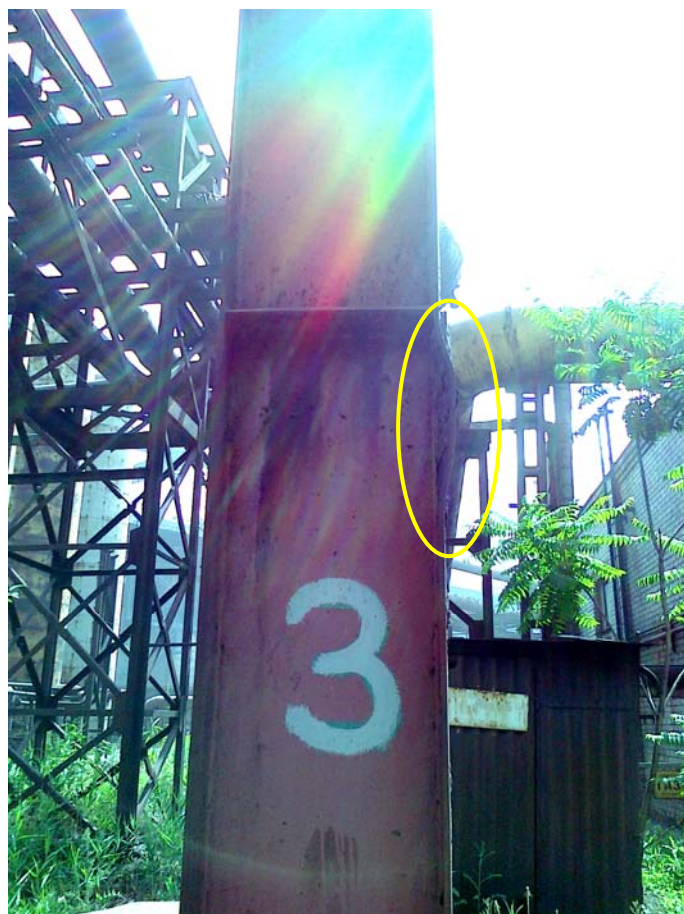
Фото 7 – Механическое повреждение полки опоры К3, по оси 3 – погнутость f=35\text{мм} , L=300\text{мм} . Профиль трассы 4-7. Категория повреждения по [2] – Б, группа 6.2, таблица 10
