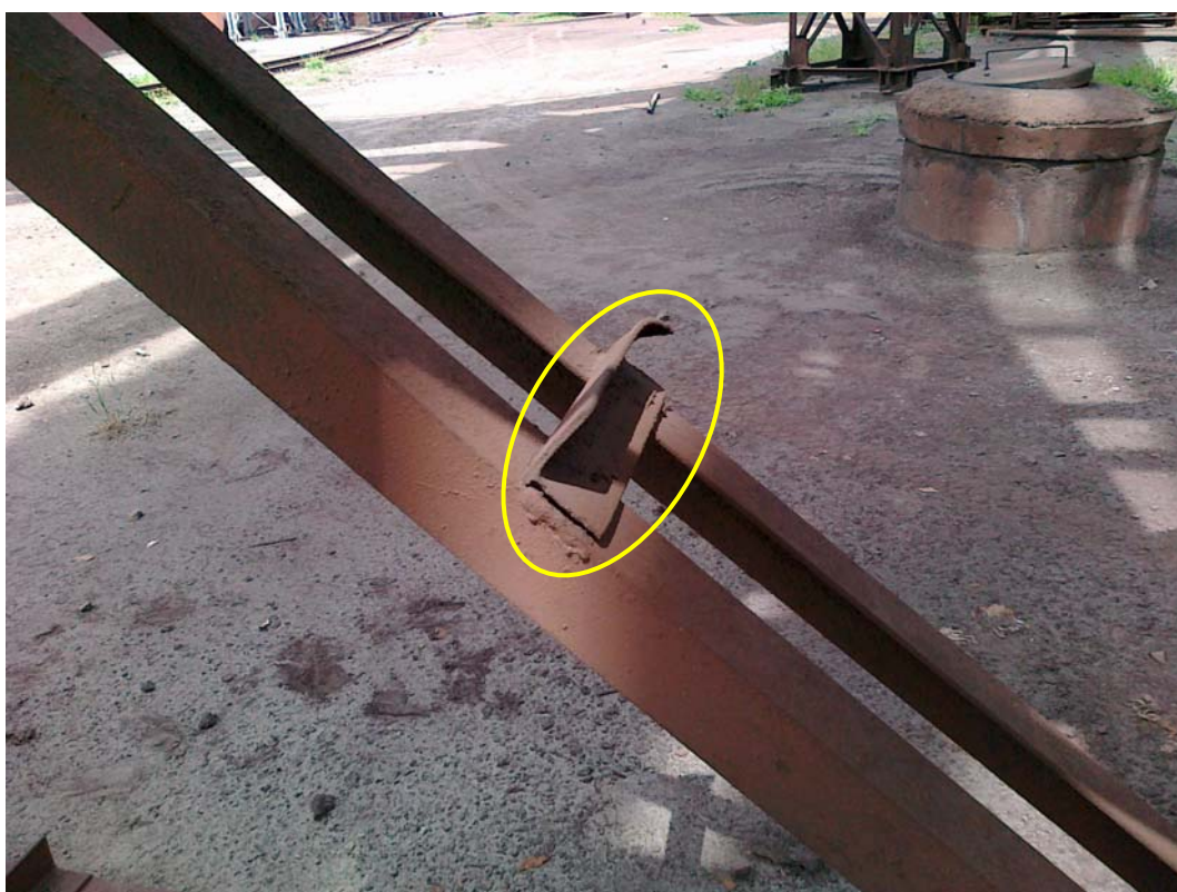
Фото 14 – Разрушение сварного шва крепления уголка решетки опоры К-4а по оси 4; смалковка полки уголка решетки опоры на величину f=20\text{мм} . Профиль трассы 2-7. Категория повреждений по [2] – А, группа 4.12; В, группа 6.9, таблица 10
