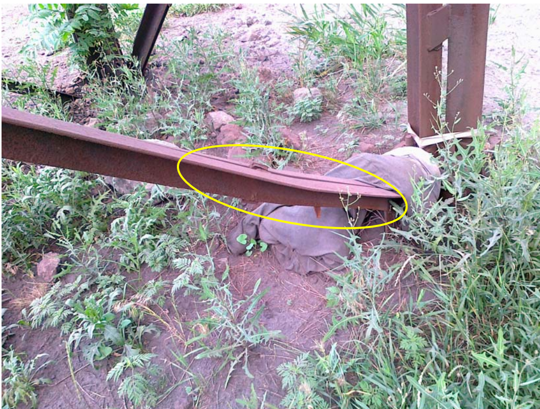
Фото 9 – Механическое повреждение раскоса решетки опоры К-2, по оси 2, погнутость f=20\text{мм} , L=1000\text{мм} . Профиль трассы 2-7. Категория повреждения по [2] – Б, группа 6.1, таблица 10
