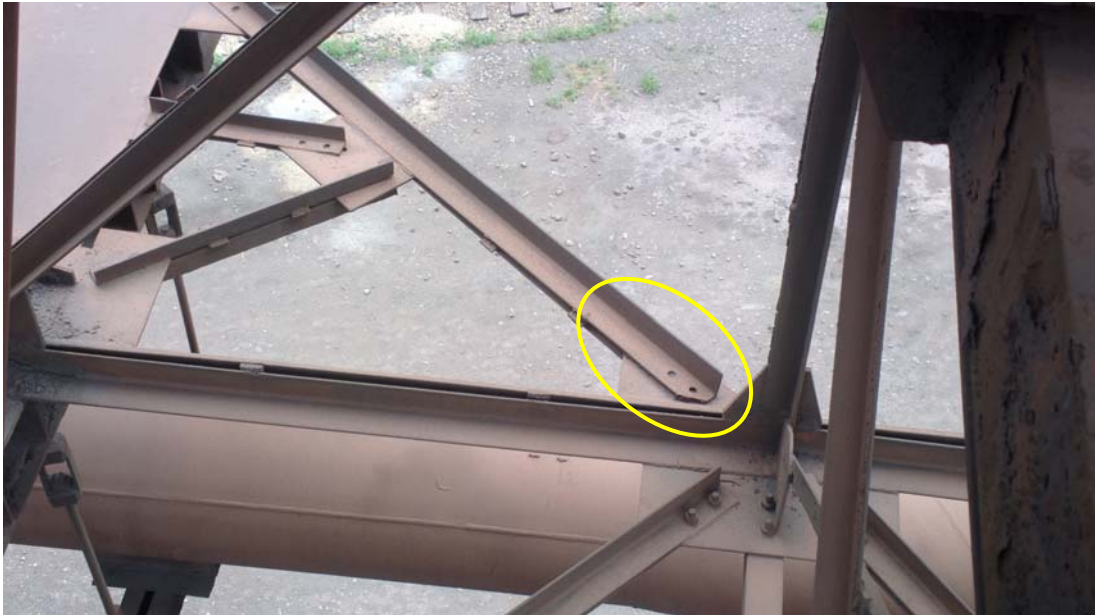
Фото 3 – Разрушение сварного шва крепления элемента траверсы фермы к фасонке, ферма Ф-4 в осях 4-5. Профиль трассы 2-7. Категория повреждения по [2] – А, группа 4.12, таблица 10
