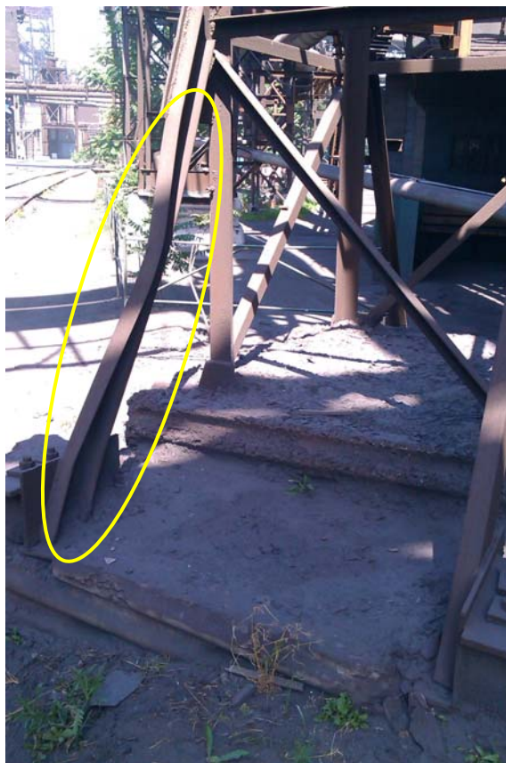
Фото 22 – Механическое повреждение подкоса опоры К21 по оси 454 на участке L=1500\text{мм} . Профиль трассы 433-455. Категория повреждения по [2] – Б, группа 6.1, таблица 10
