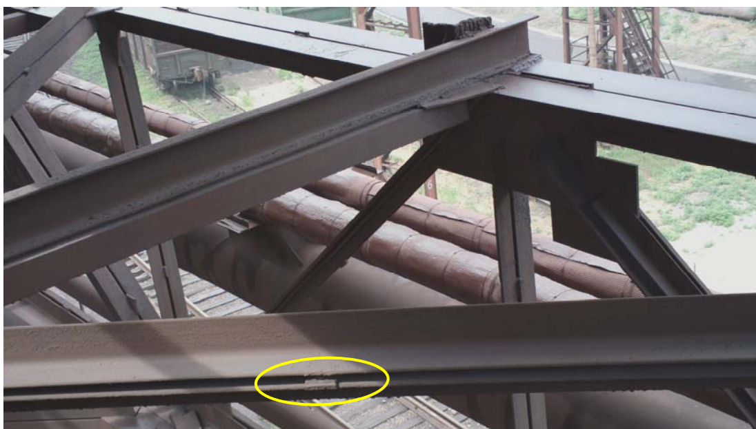
Фото 2 – Характерное повреждение – разрушение сварных швов крепления промежуточных прокладок составных элементов из уголков (нижний пояс фермы, горизонтальные связи по верхним поясам пролетного строения). Профиль трассы 2-7. Категория повреждения по [2] – А, группа 4.12, таблица 10
