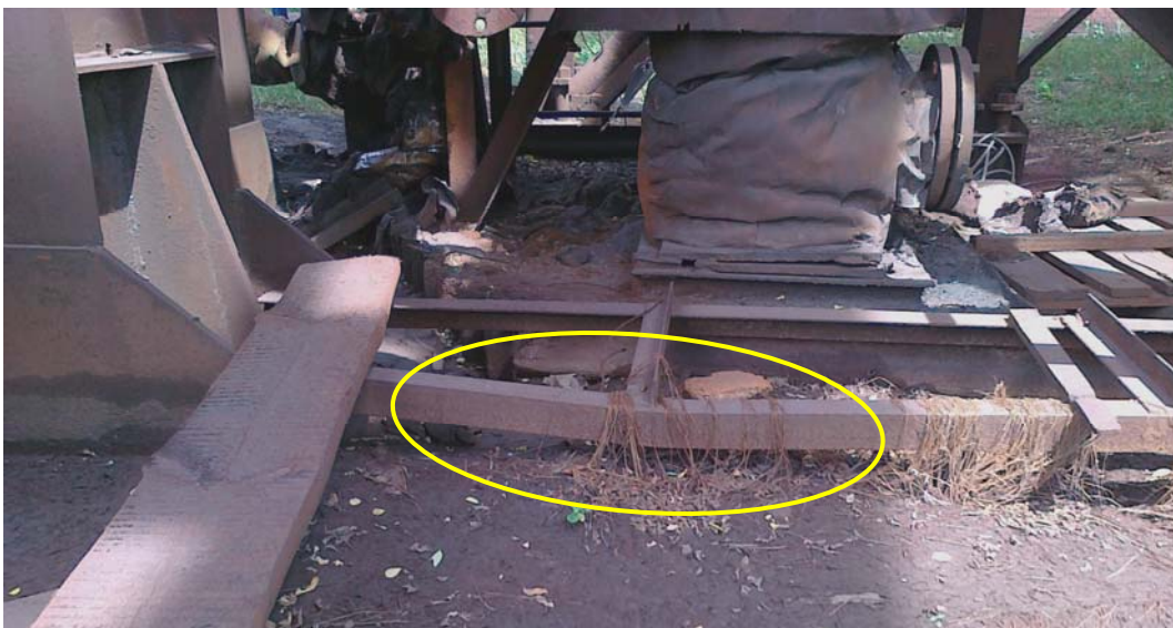
Фото 17 – Механическое повреждение конструкции распорки – деформация уголка, опора К-6 ось 6, L=1000мм, f=20мм. Профиль трассы 2-7. Категория повреждения по [2] – Б, группа 6.1, таблица 10
