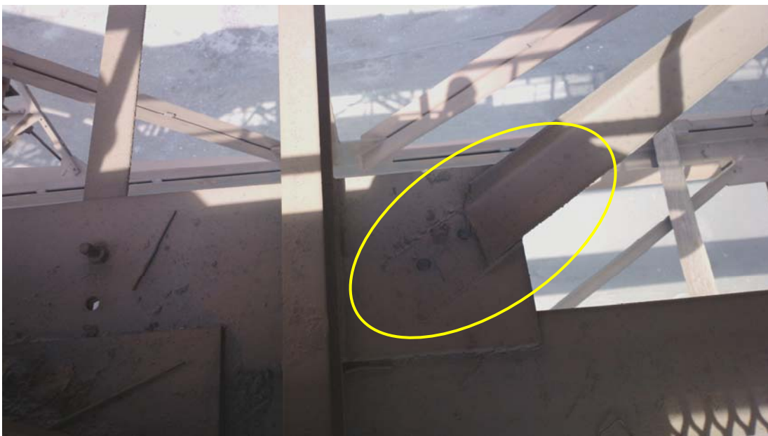
Фото 4 – Вырез участка горизонтальной связи по верхним поясам ферм Ф-5 (механическое повреждение). Недостаточная длина сварного шва крепления связи к фасонке. Профиль трассы 2-7. Категория повреждения по [2] – А, группы 4.12; 4.13, таблица 10
