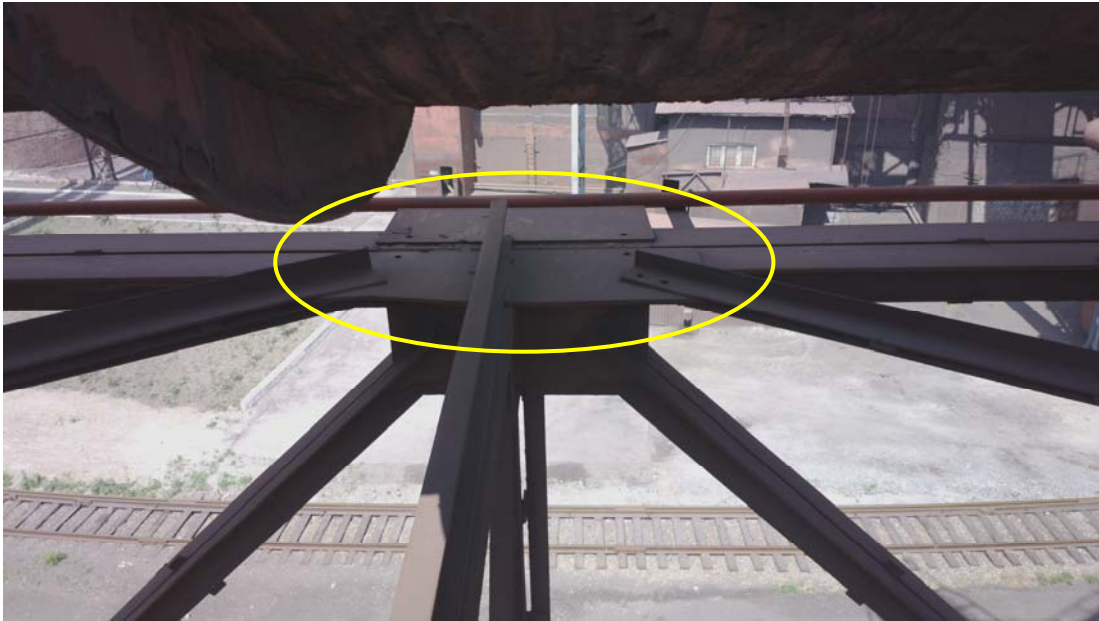
Фото 5 – Механическое повреждение – погнутость узловой фасонки фермы Ф-5 на величину \alpha \approx 2^\circ . Профиль трассы 2-7. Категория повреждения по [2] – Б, группа 6.6, таблица 10
