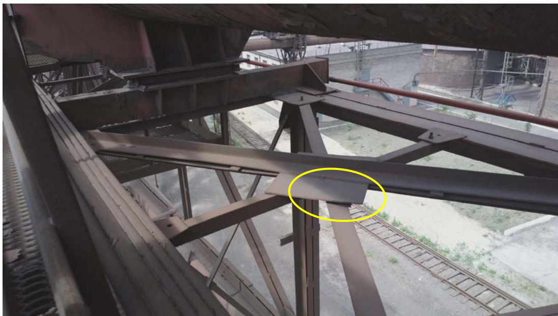
Фото 1 – Характерное повреждение – разрушение сварного шва крепления фасонки к ветви горизонтальной связи пролетного строения. Профиль трассы 2-7. Категория повреждения по [2] – А, группа 4.12, таблица 10
