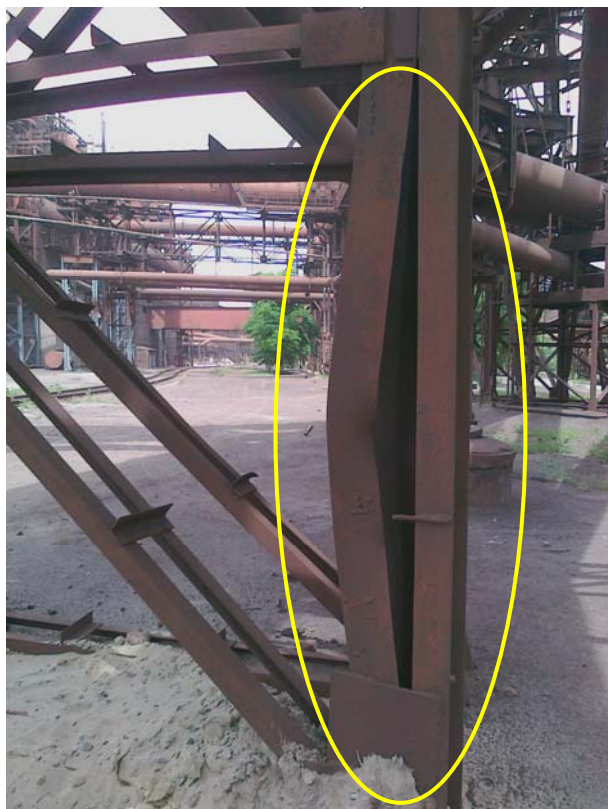
Фото 13 – Механическое повреждение ветви опоры с последующим усилением, опора К-4а ось 4. Профиль трассы 2-7
