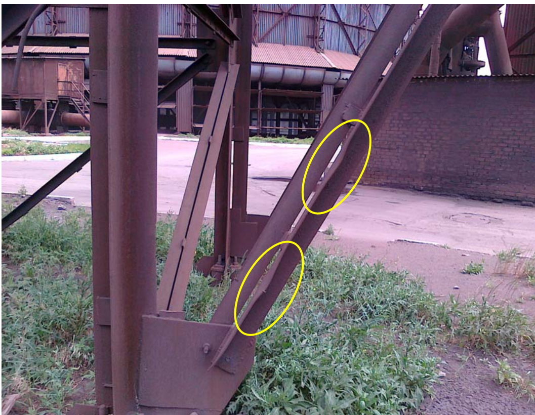
Фото 12 – Смалковка полки уголка вертикальной связи подкоса опоры К-2 по оси 2, f=10\text{мм} , L=200\text{мм} . Профиль трассы 2-7. Категория повреждения по [2] – В, группа 6.9, таблица 10
