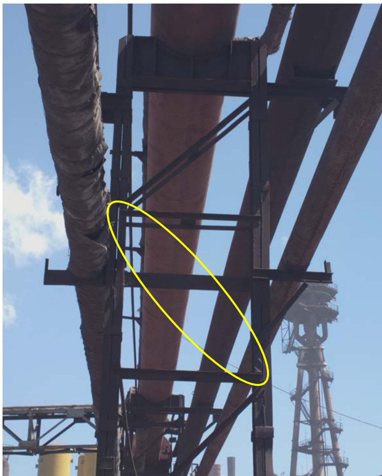
Фото 18 – Вырез раскосов решетки опоры К8 по оси 440. Профиль трассы 433-455. Категория повреждения по [2] – А, группа 1.1, таблица 10
