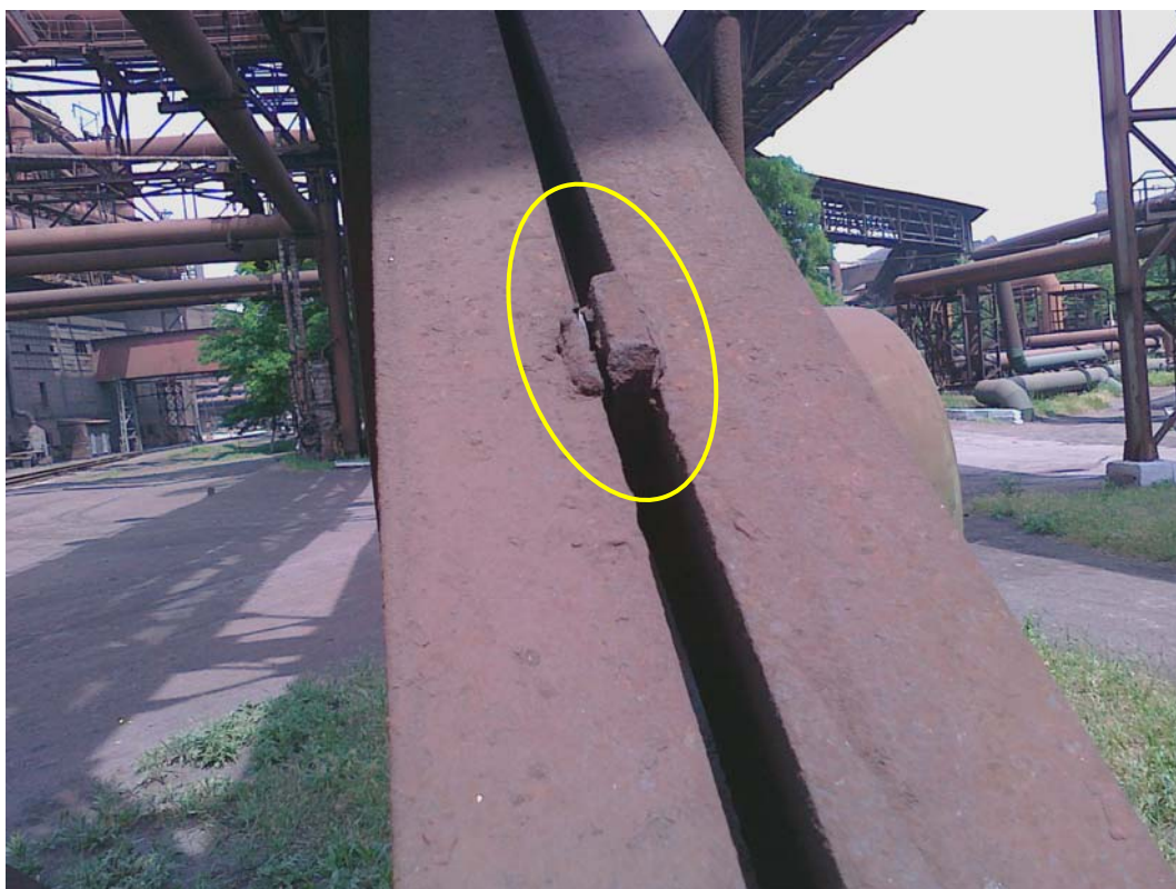
Фото 16 – Характерное повреждение – разрушение сварных швов крепления промежуточных прокладок составных элементов в конструкции связей, опора К-5 ось 5. Профиль трассы 2-7. Категория повреждения по [2] – А, группа 4.12, таблица 10
