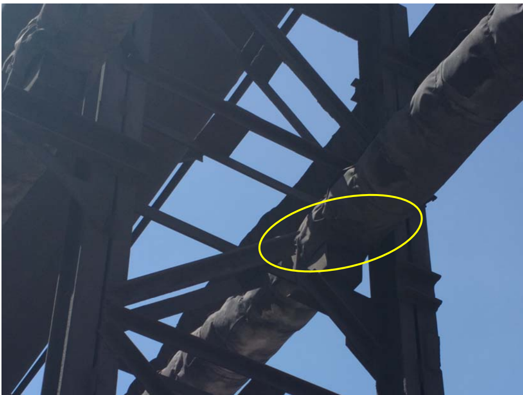
Фото 21 – Вырез участков раскоса опоры К13 по оси 446. Профиль трассы 433-455. Категория повреждения по [2] – А, группа 1.1, таблица 10
