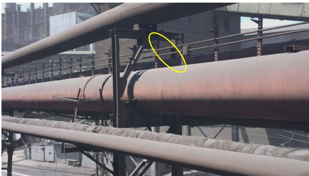
Фото 20 – Вырез подкоса опоры К11 по оси 444. Профиль трассы 433-455. Категория повреждения по [2] – А, группа 1.1, таблица 10
