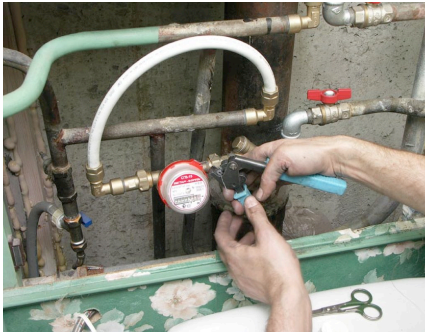
Рис. 6.19. Встановлення лічильника гарячої води.
