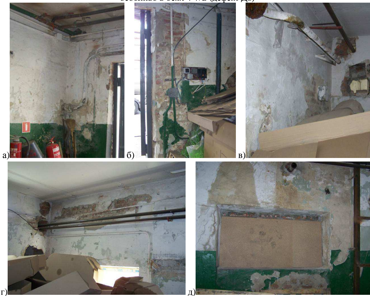
Фото 19. Сліди замкання, руйнування та відшарування оздоблення стін в осях 1-3/Е (а-в), 4-7/Е (г-д) (дефект Д9)
