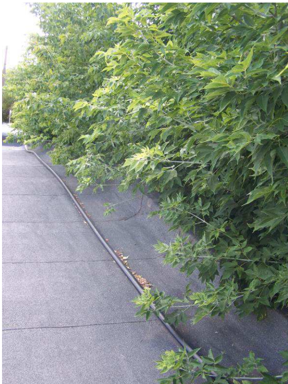
Фото 13. Повна відсутність вимощення вздовж фасаду в осях А-Е/15; дерева ростуть впритул до будівлі (дефект Д3)
