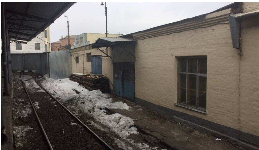
Фото 8. Загальний вигляд фасаду одноповерхової частини будівлі цеху фасування, складу тари в осях 15-9
