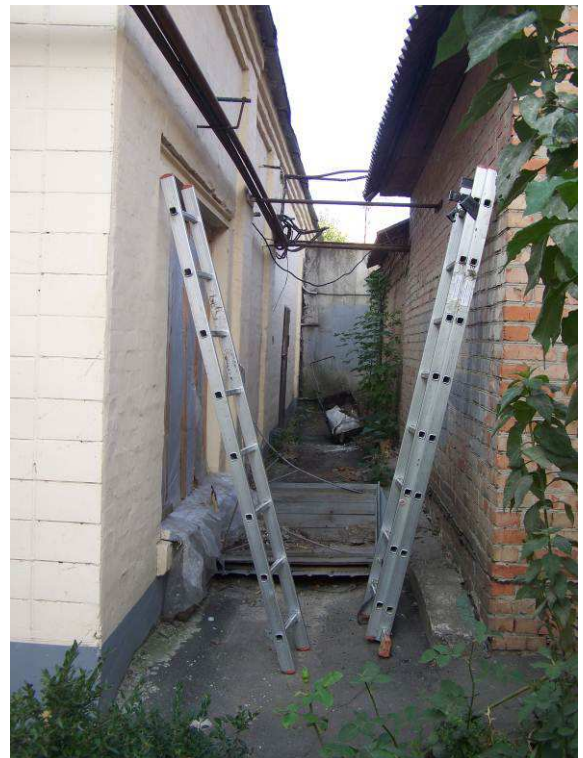
Фото 14. Безстічний майданчик вздовж фасаду в осях 9-11/А між будівлею складу тари та будівлею магазину (дефект Д4)
