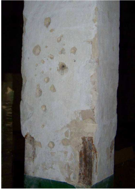
Фото 24. Локальне руйнування ядра та корозійні пошкодження сталевих кутиків обойми колон в осях 4-7/Д (дефект Д14)
