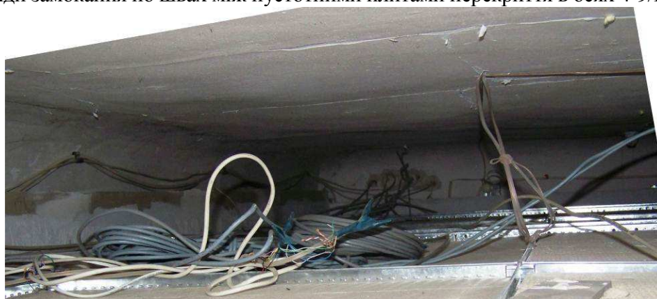
Фото 23. Розтріскування шару штукатурки, яка виконана по шару дерев'яної дражки в осях 1-4/Б-Е (дефект Д13)
