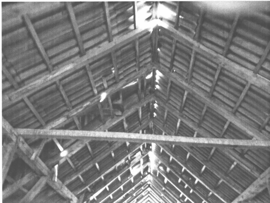
Фото 6. незадовільний стан даху
