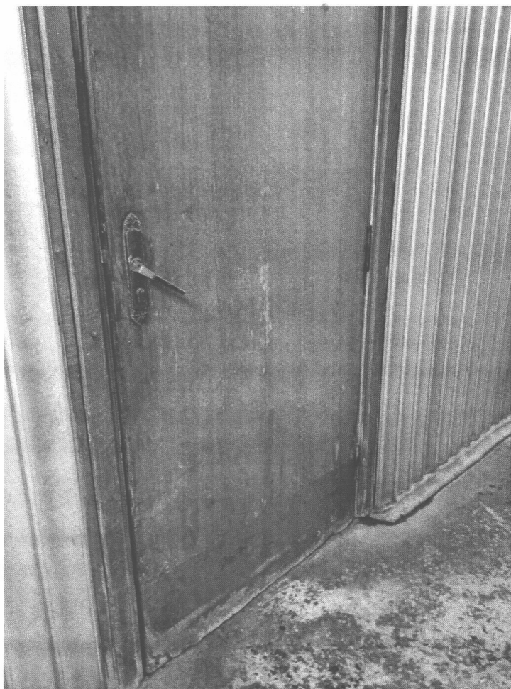
Фото 3. Незадовільний стан заповнення дверних прорізів
