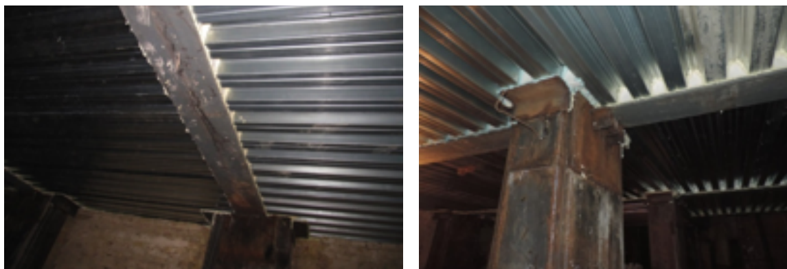
Рисунок 1.3. Пример использования перекрытия пониженной высоты при реконструкции здания в Киеве (проект «Вартіст»)
