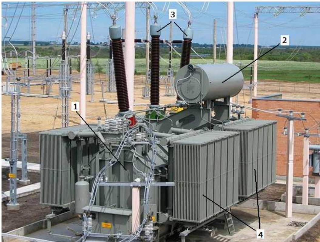
Рис.42 Маслонаповнений шунтуючий реактор типу УШРТ 330 кВ
