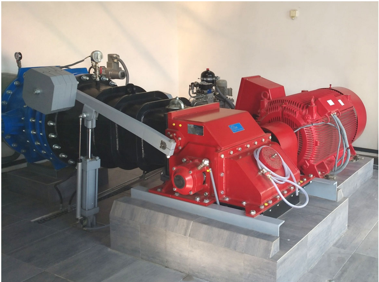
Рис. 1.16 – Гідроелектричний агрегат МГЕС «ПОЛТАВА ГІДРО»
