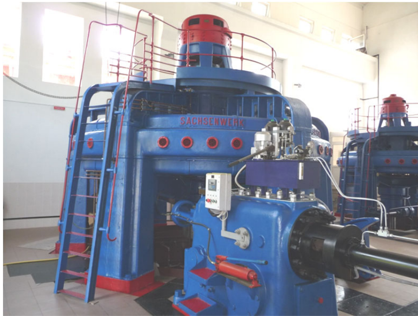
Рис. 2.27 – Машинна зала ГЕС потужністю 1500 кВт
