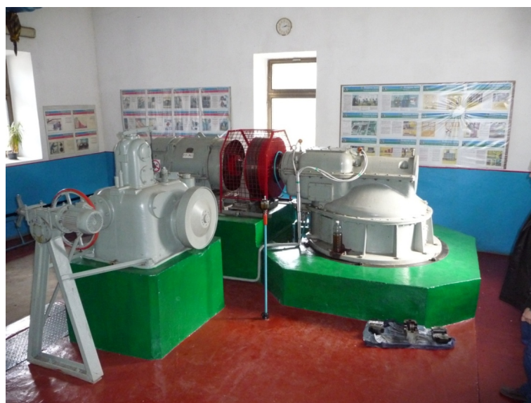
Рис. 2.26 – Машинна зала ГЕС потужністю 120 кВт
