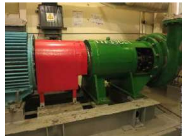
Насосний агрегат TF33D01 у приміщенні теплообмінника системи охолодження промконтура енергоблоку № 1 Балаковської АЕС (РФ)
