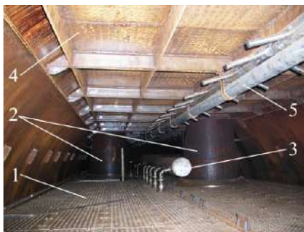
Рис. 5.38. Внутрішньокорпусні пристрої парогенератора: 1 – занурювальний отвірний лист; 2 – колектори теплоносія I контура 3 – трубопровід з пристроями роздачі живильної води; 4 – пароприймальний отвірний лист; 5 – трубопровід підведення аварійної живильної води Ду 100
