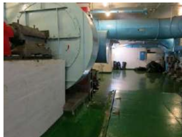
Приміщення з витяжними вентагрегатами енергоблоку № 1 Балаковської АЕС (РФ)
