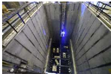
Стелажі у басейні витримки ВЯП енергоблоку № 1 Ленінградської АЕС-2 (РФ)
