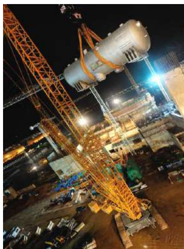
Підйом парогенератора ПГВ-1000МКП вагою 330 т важким краном Liebherr LR 11350 на транспортну естакаду енергоблоку № 1 Ленінградської АЕС-2 (РФ)
