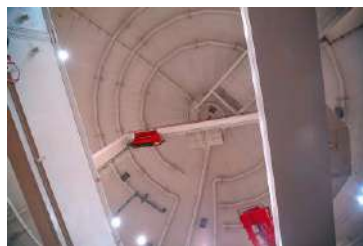
Загальний вигляд спринклерної системи енергоблоку № 2 Балаковської АЕС (РФ)
