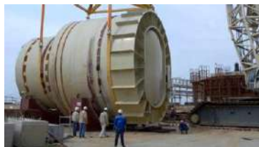
Шлюз транспортний гермооболонки енергоблоку № 7 Нововоронезької АЕС (РФ)
