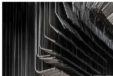
Теплообмінні трубки всередині корпусу парогенератора
