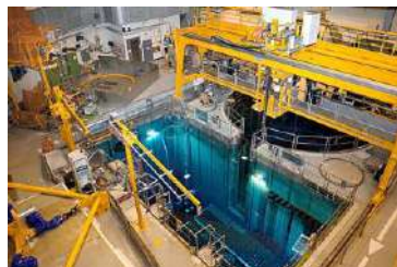
Басейн витримки ВЯП, що з'єднаний перевантажувальним каналом з шахтою реактора ВВР-4 (АЕС "Мюлеберг", Швейцарія)
