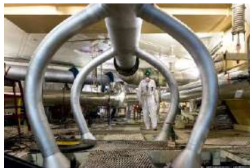
Колектор пари з патрубками парогенератора ПГВ-1000М енергоблоку № 2 Балаковської АЕС (РФ)
