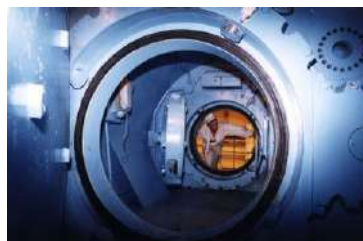
Шлюз аварійний гермооболонки енергоблоку № 5 Запорізької АЕС (Україна)
