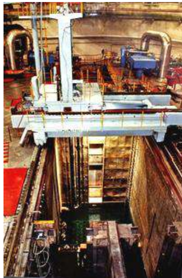
Перевантажувальна машина МПС-В-1000-3 над басейном витримки ВЯП енергоблоку № 2 Балаковської АЕС (РФ)
