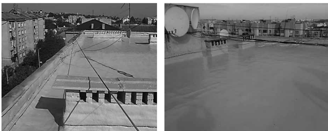
Рис.2.5. Зовнішній вигляд покрівлі, ремонт якої виконаний із застосуванням приладів інфрачервоного опромінення та з улаштуванням багатошарового монолітного теплоізоляційного покриття із пінополіуретану
