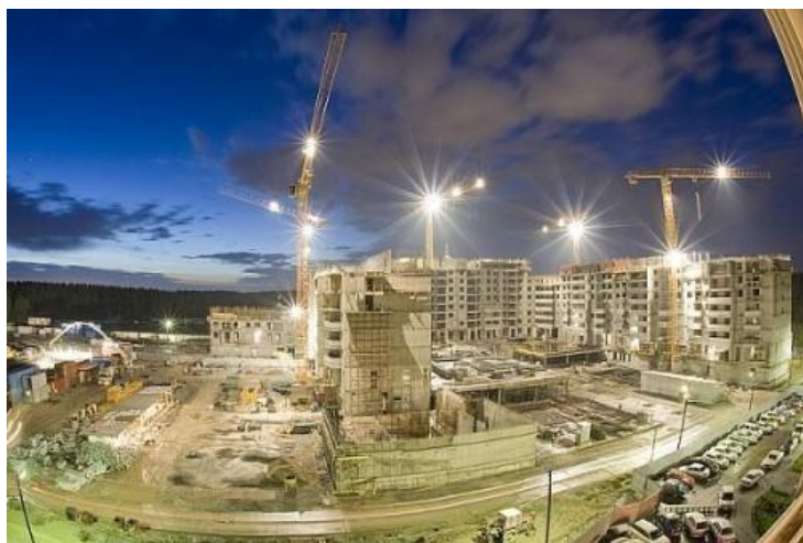
Рис. 4.1. Освітлення будівельного майданчика
