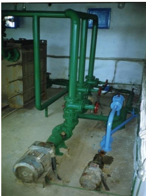
Рис. 6.6. Мережевий насос та насос для підживлення
