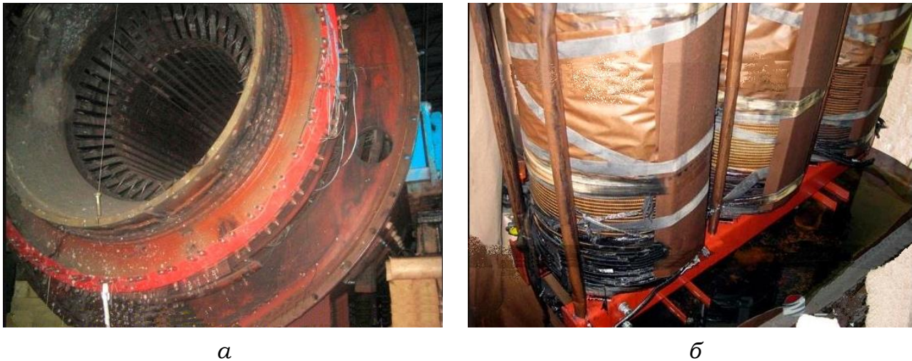
Рисунок 8.1 – Пошкодження турбогенератора та трансформатора через виткові КЗ
