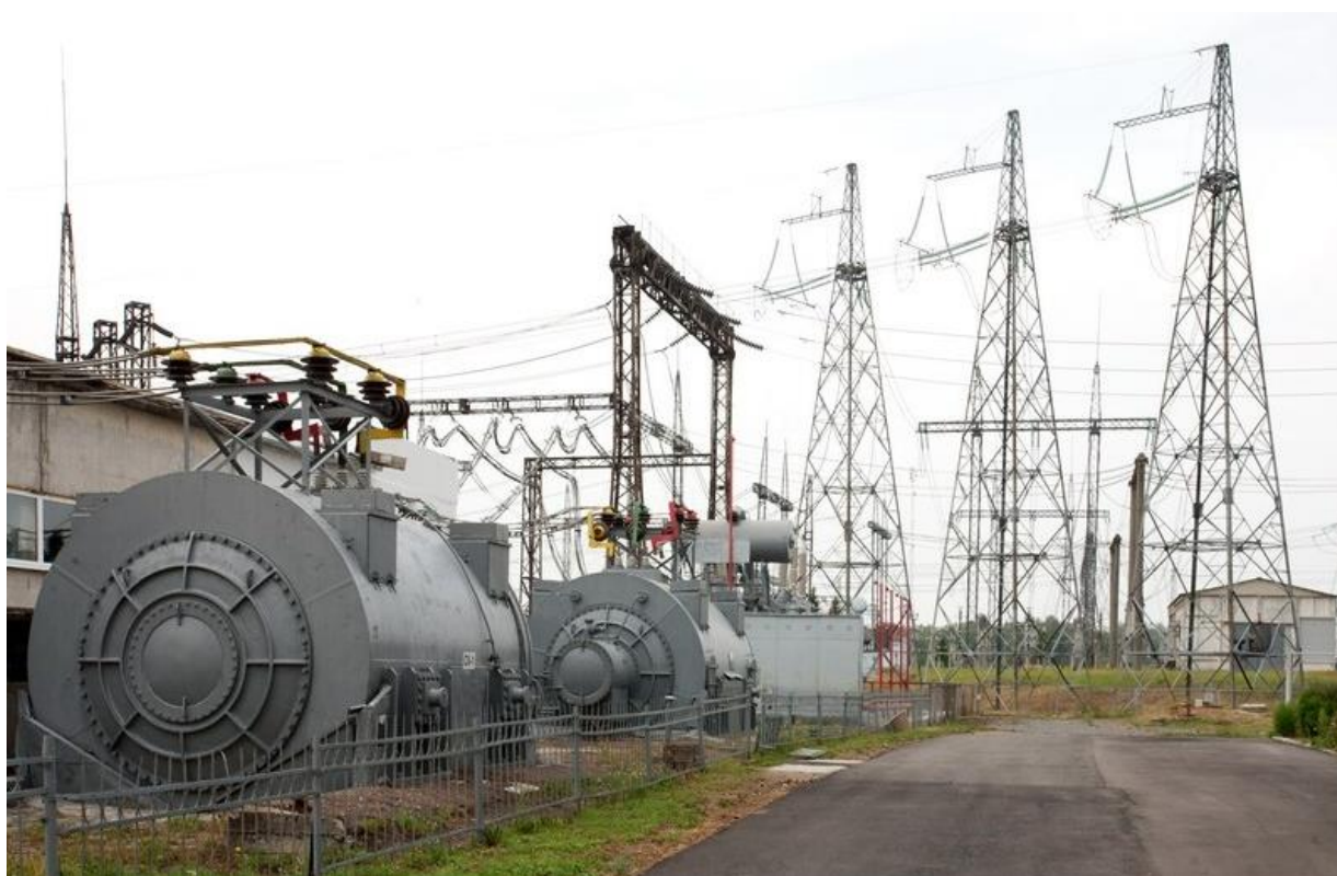
Рисунок 5.5 – Синхронні компенсатори на підстанції
