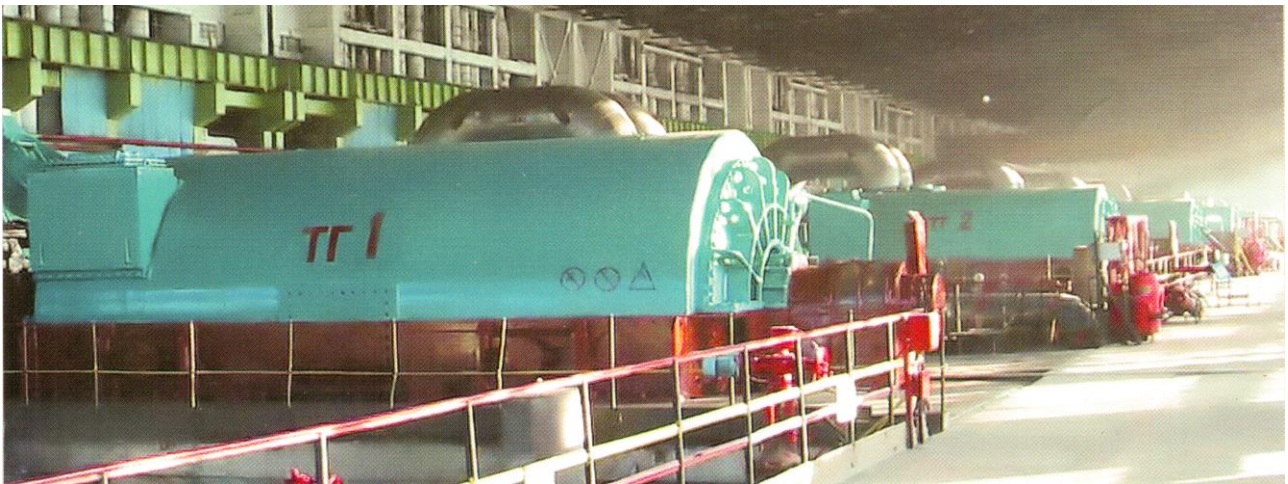
Рисунок 1.8 – Турбогенератори в машинному залі ТЕС
