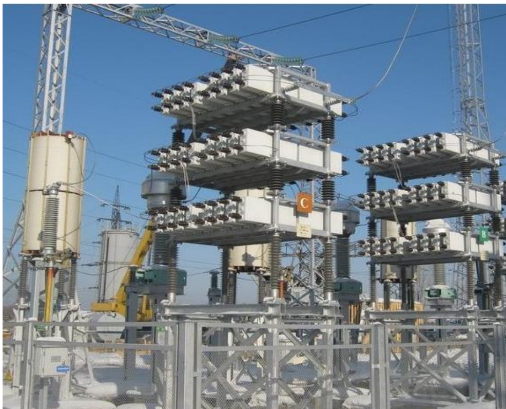
Рисунок 5.10 – Силві конденсатори на підстанції
