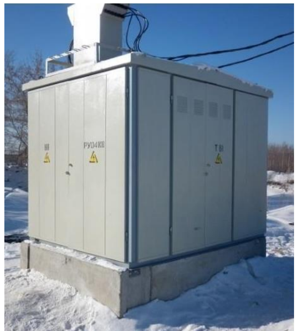
Рисунок 10.9 – Комплектна трансформаторна підстанція
