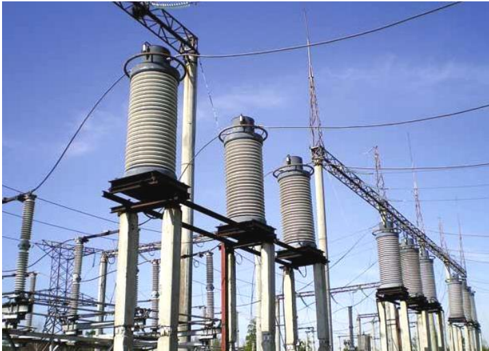
Рисунок 7.3 – Трансформатори струму на підстанції
