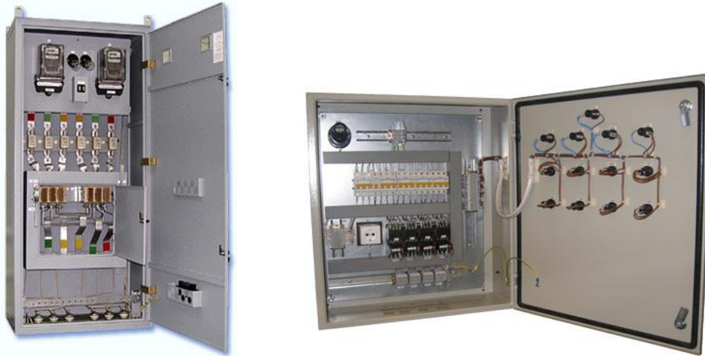
Рисунок 10.10 – Пристрої електрощитового обладнання
