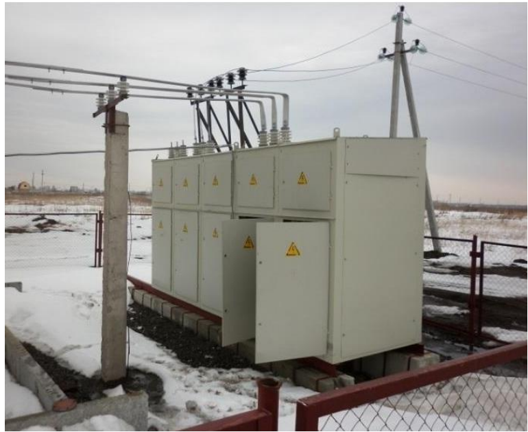
Рисунок 10.8 – Комплектний розподільний пристрій зовнішньої установки
