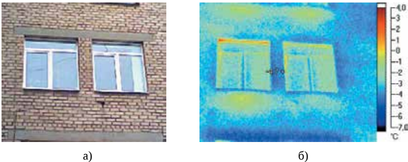
Рис. 2.7. Ділянка стіни, сфотографована фотокамерою (а) та тепловізором (б): під правим вікном встановлено тепловий екран (з ізолону), під лівим – тепловий екран відсутній
