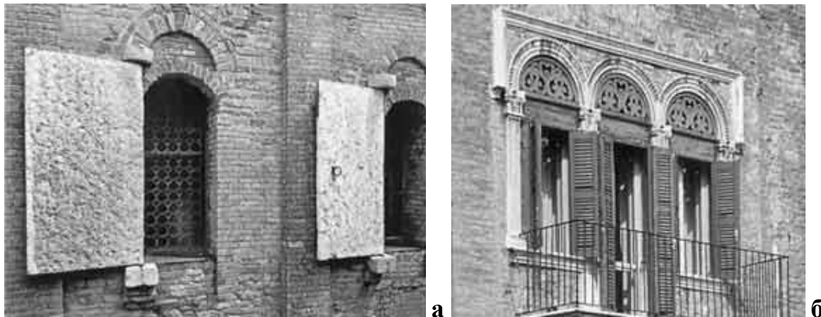
Рис.1. Кам'яні віконниці, Torcello, Італія (а). Віконниці-жалюзі захищають від сонця і регулюють вентиляцію, Монтана, Італія (б).
