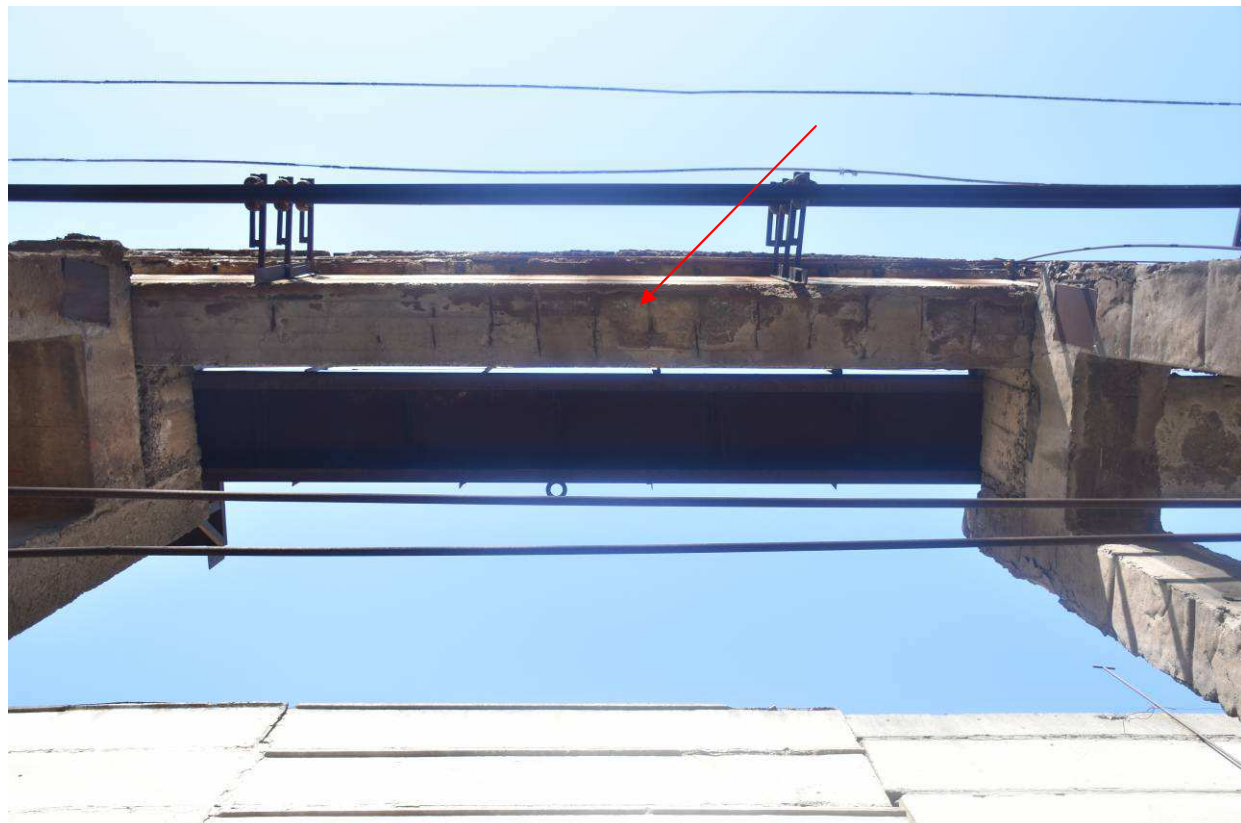
Фото 7 Д11 - руйнування захисного шару бетону, оголення та поверхнева корозія арматури залізобетонних підкранових балок Д12 – тріщини вздовж арматурних стрижнів підкранових балок
