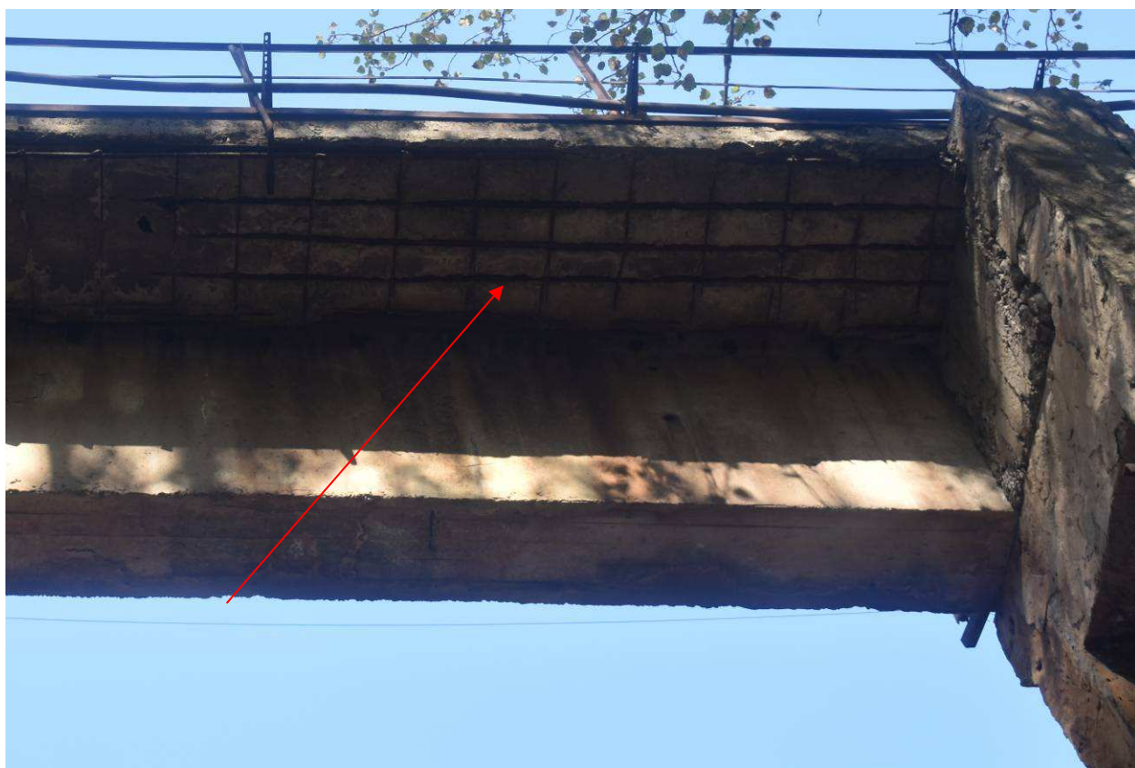
Фото 10 Д9 - руйнування захисного шару бетону, оголення та корозійні пошкодження арматури залізобетонних плит
