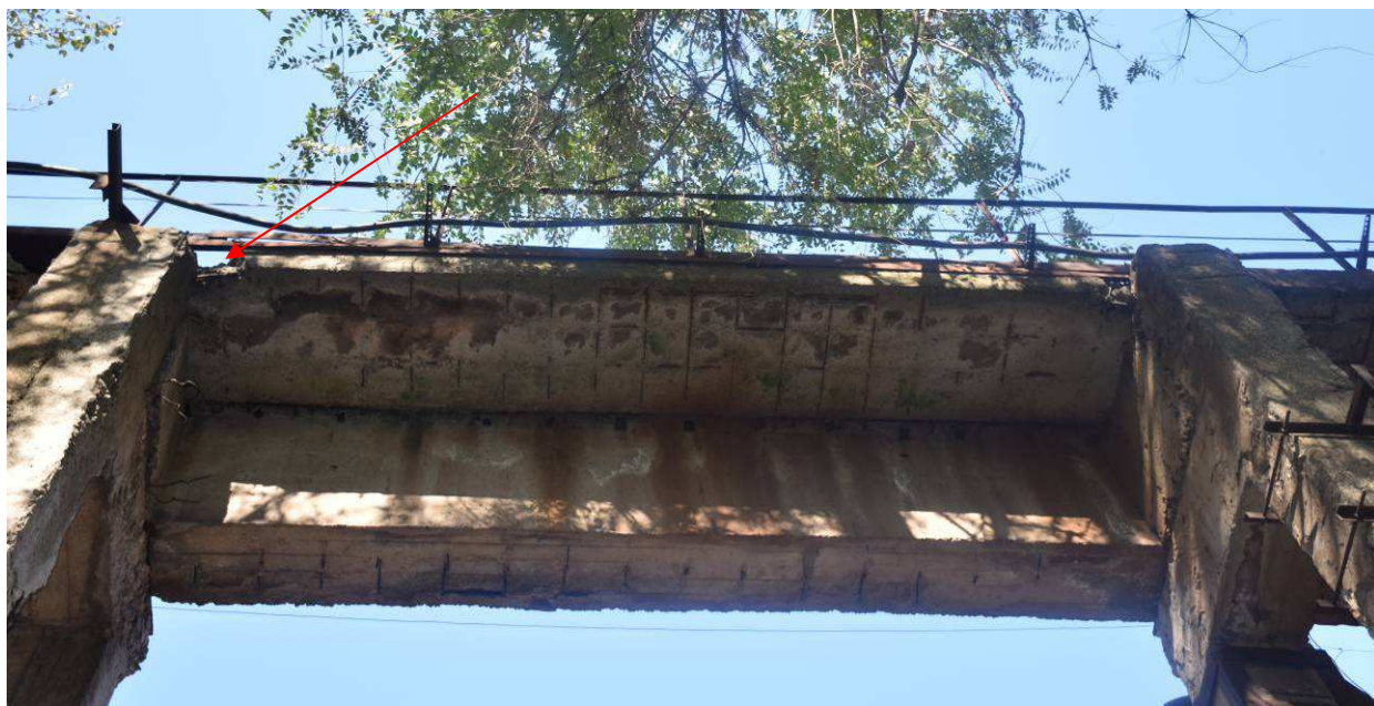
Фото 9 Д8 - наскрізне руйнування бетону в кутах залізобетонних плит
