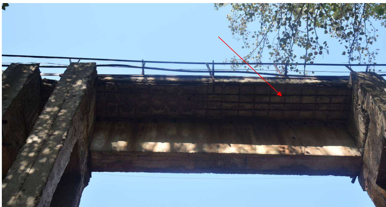
Фото 8 Д7 - руйнування захисного шару бетону вздовж стрижнів арматури залізобетонних плит.
