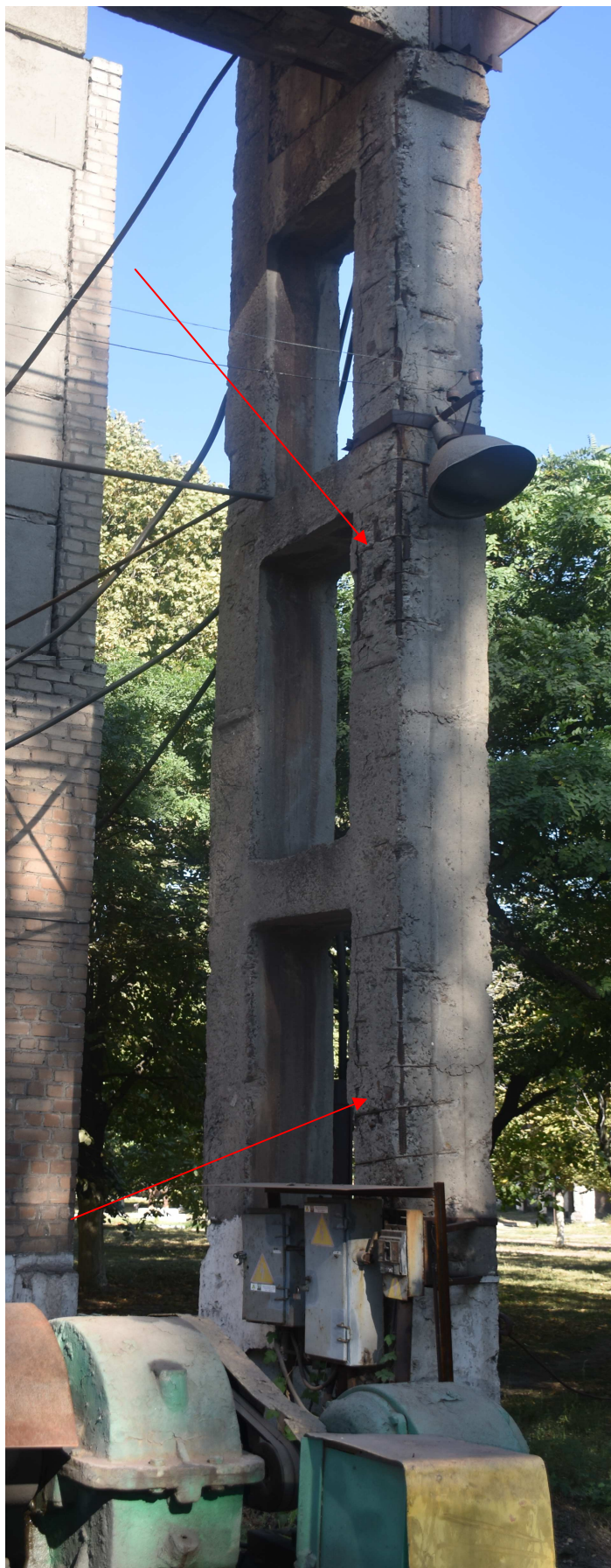
Фото 1 Д1 - руйнування захисного шару бетону, оголення та корозійні пошкодження арматури двогілкових залізобетонних колон естакади
