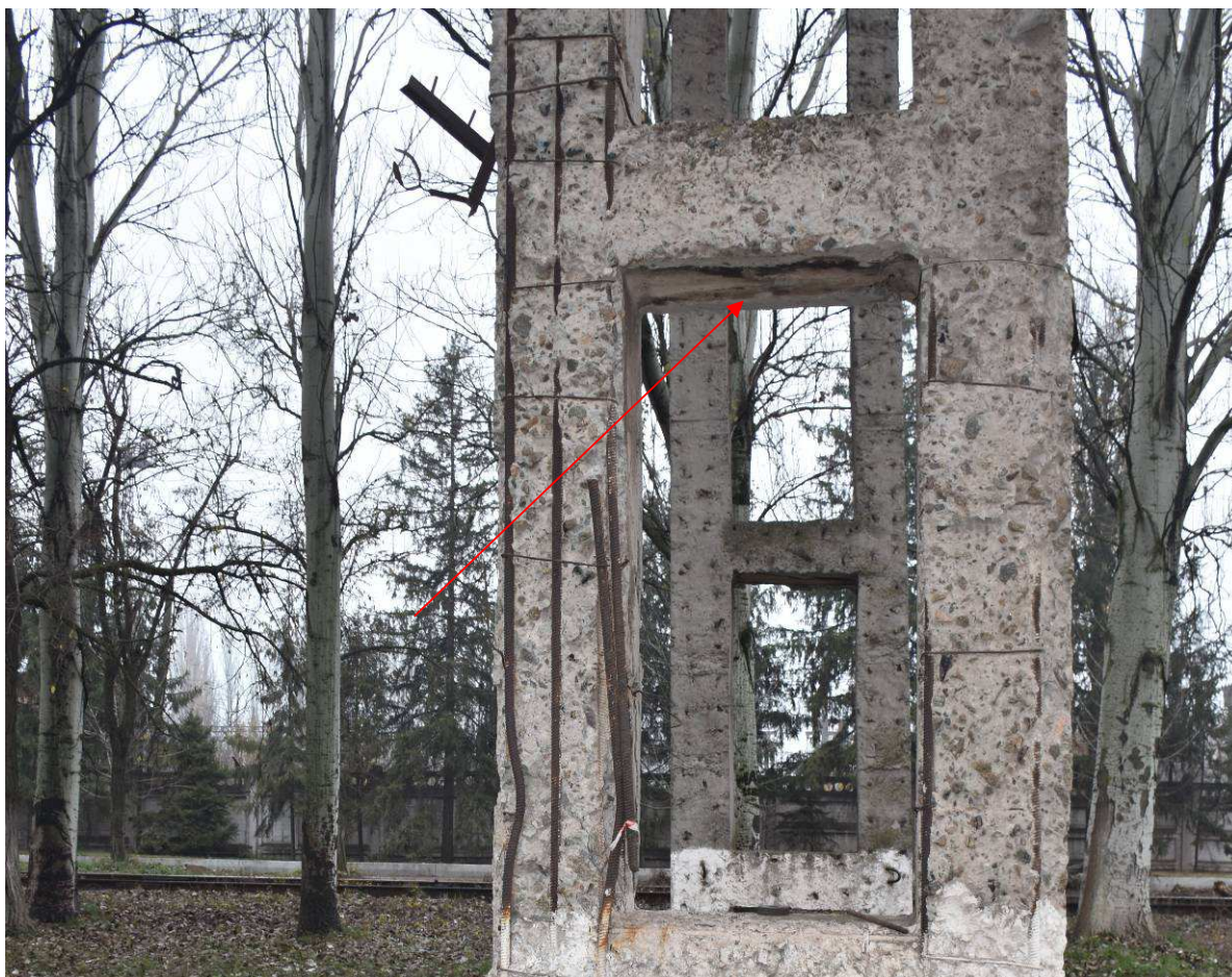
Фото 5 Д6 - тріщина в перемичці між гілками залізобетонних колон естакади (колона К-17).
