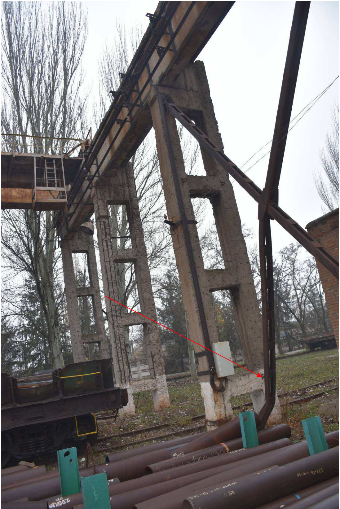
Фото 6 Д14 – погнутість металевого елемента.
