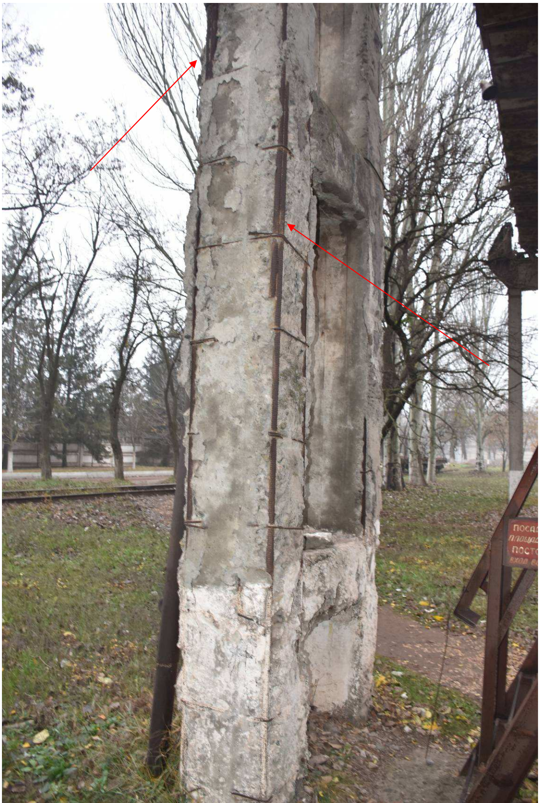
Фото 2 ДЗ - сколювання бетону по ребрах, оголення та корозія арматури залізобетонних колон естакади
