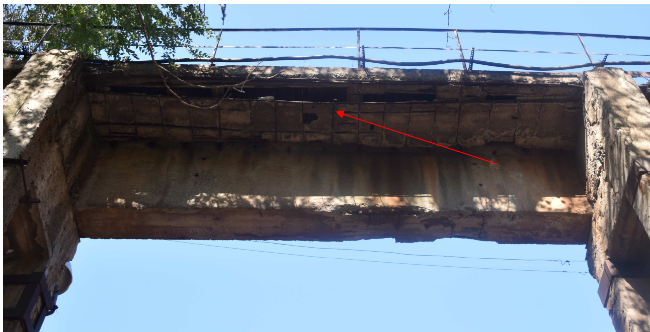
Фото 11 Д10 - руйнування захисного шару бетону, оголення та корозійні пошкодження арматури до 20 %, прогини конструкцій
