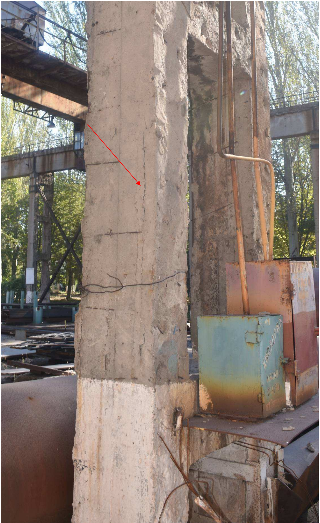
Фото 3 Д4 - тріщини вздовж стрижнів арматури
