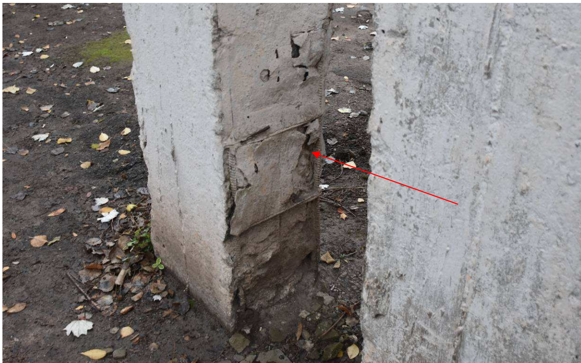
Фото 4 Д5 - пухкість, розтріскування, відшарування захисного шару бетону залізобетонних колон естакади
