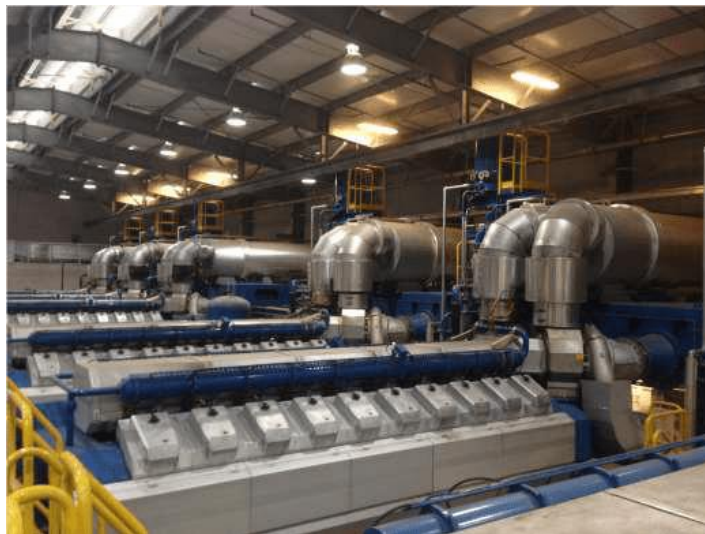
Рис. 13.3. Машинна зала електростанції, оснащеної ДВС.
