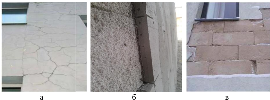
Рис.4. Разрушение и отслаивание штукатурного покрытия от кладки
