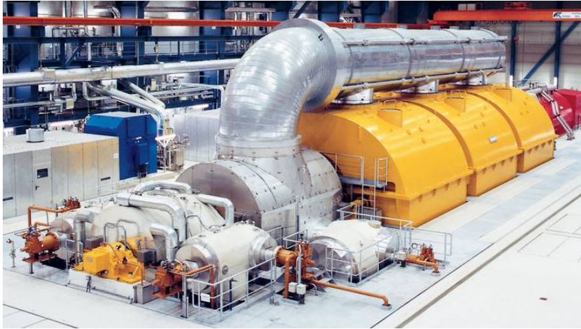
Рисунок 2.18 – Енергоблок сучасної теплоелектро-станції в складі парових котлів, турбін і генераторів
