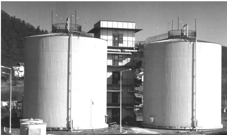
Рис. 14.27. Металеві метантенки очисної станції м. Ясло (Польща)
