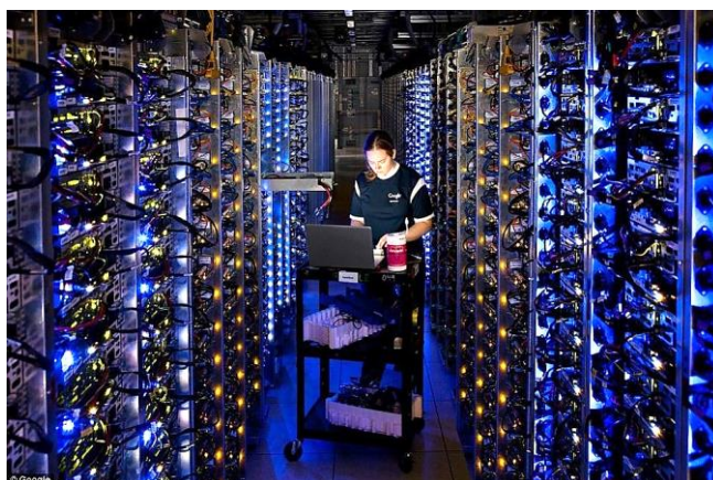
Рис. 1.3. Внутрішній вигляд центра обробки даних Google
