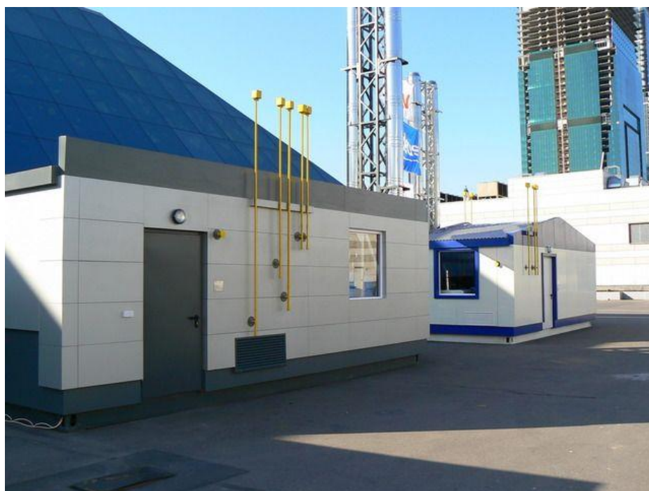
Центральный тепловой пункт
