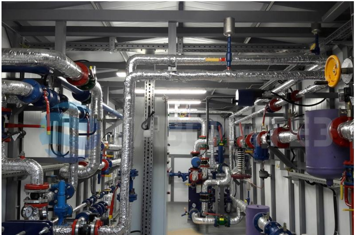
Насосні станції підкачки
