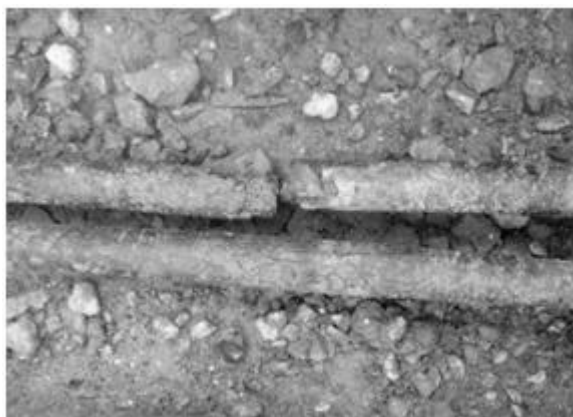
Рис.1. Результат пошкодження трубопроводу теплової мережі внаслідок зовнішньої корозії
