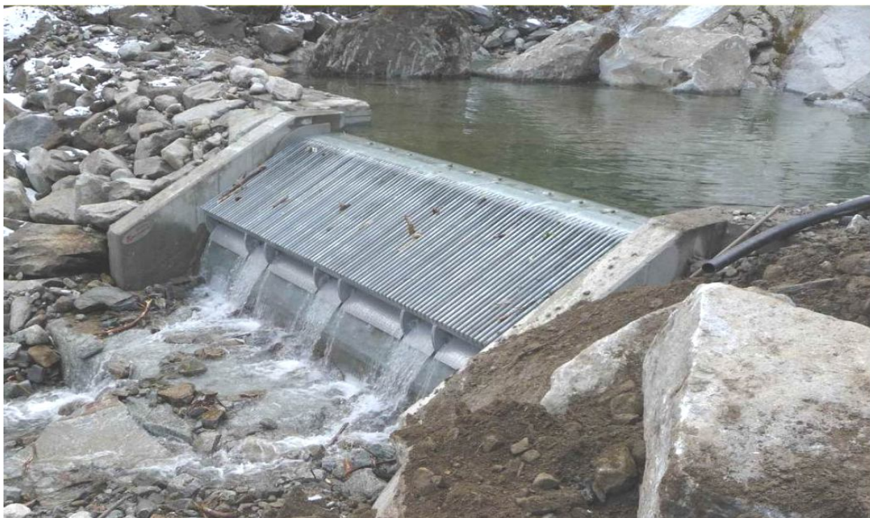
Рис. 3. Водозабір високонапірної малої ГЕС "Шипот-2".
