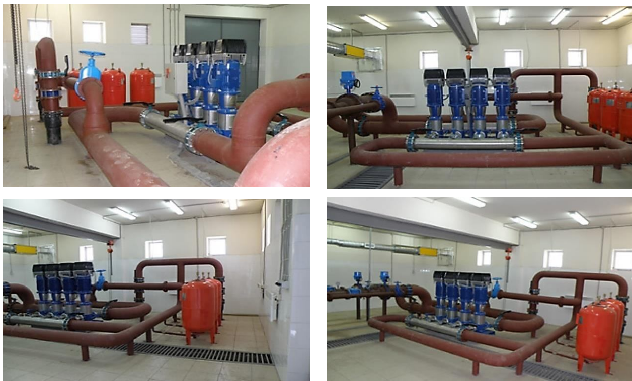
Рисунок 2.1 – Підвищувальна водопровідна насосна станція
